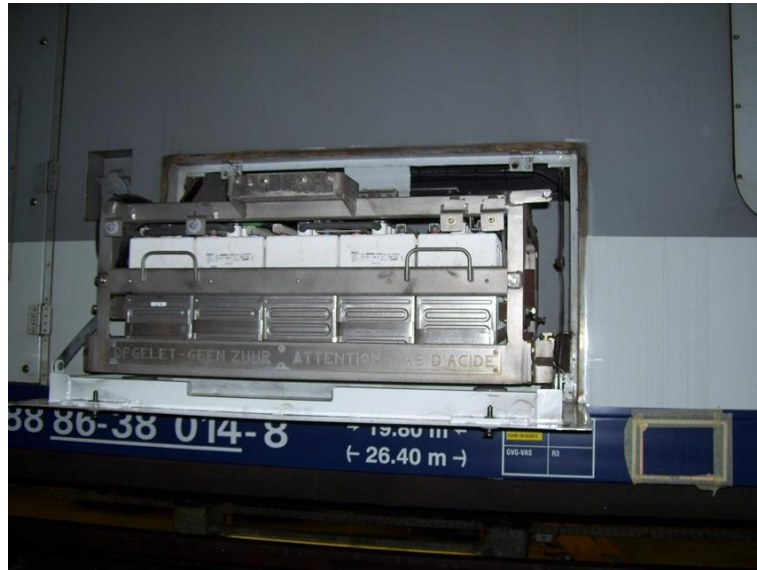
Photo 5 - M5m - Coffre batterie - Vue de face
