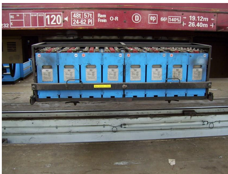
Photo 1 - AM86 - Coffre batterie - Vue de face
