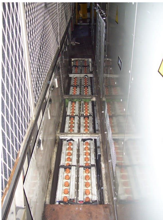
Photo 3 - HLE13 - Disposition des batteries - Vue globale
