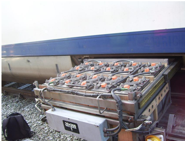
Photo 1 - I11 - Coffre batterie - Vue d'ensemble
