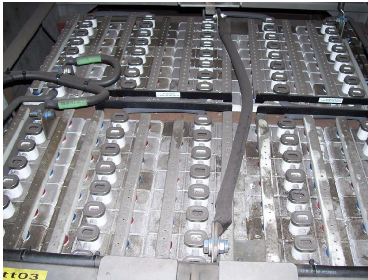
Photo 7 - M5m - Coffre batterie - Vue de haut
