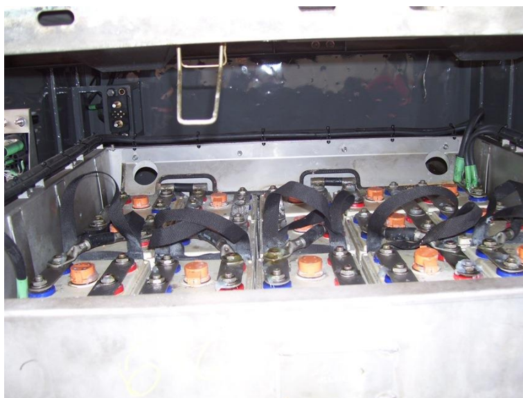
Photo 9 - M6 - Coffre batterie - Vue de face
