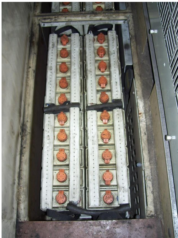
Photo 4 - HLE13 - Disposition des batteries - Vue de 4 bacs dans un renforcement
