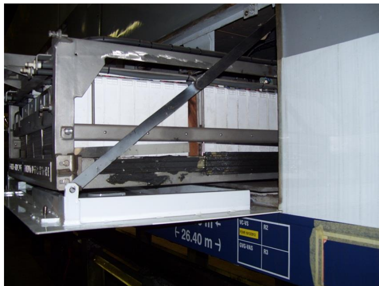
Photo 6 - M5m - Coffre batterie - Vue de côté
